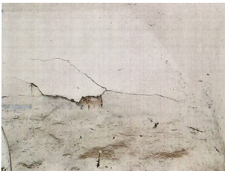
Statická trhлина na zadní stěně
