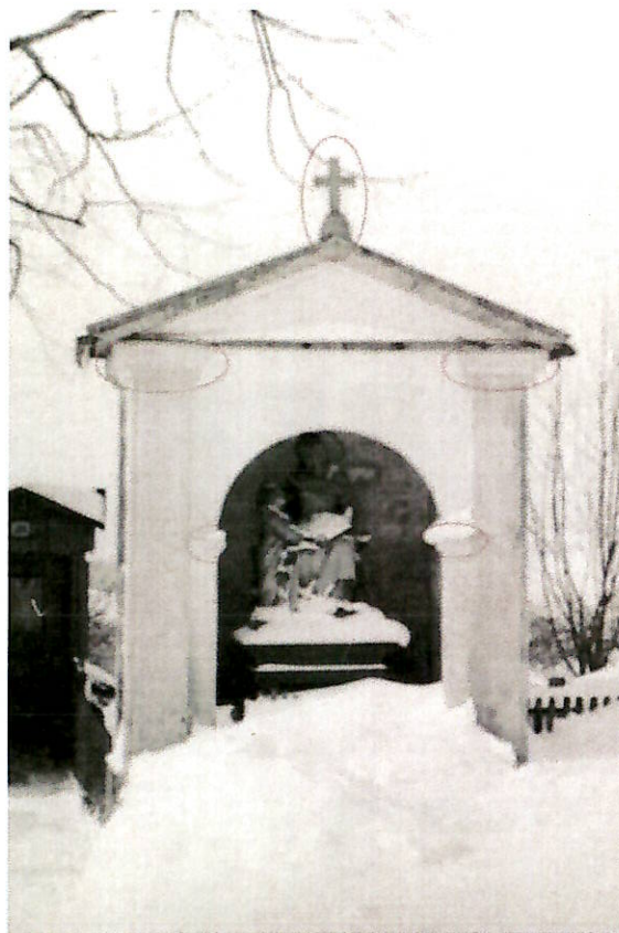
Chybějící prvky architektury
