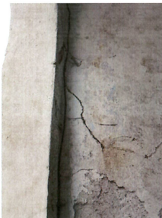
Statická trhлина na boční stěně
