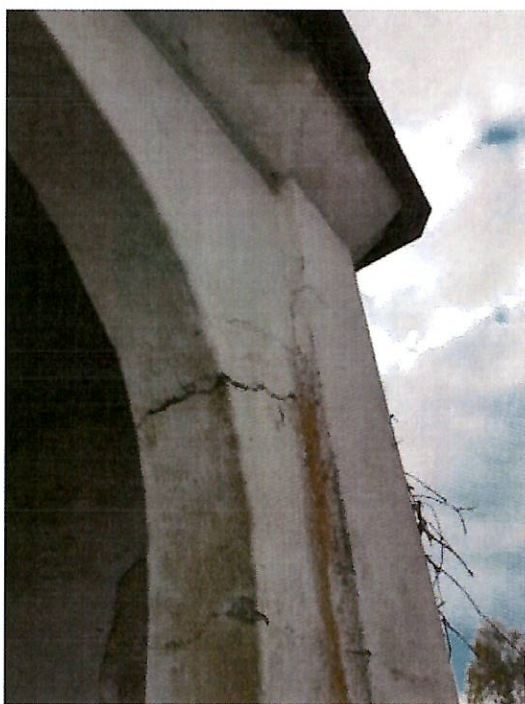
Statická trhлина na ostění
